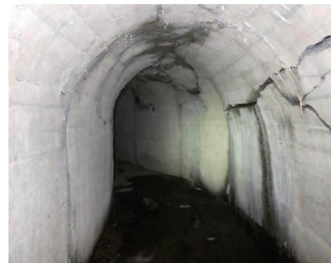
図5 取水トンネルの被災状況
