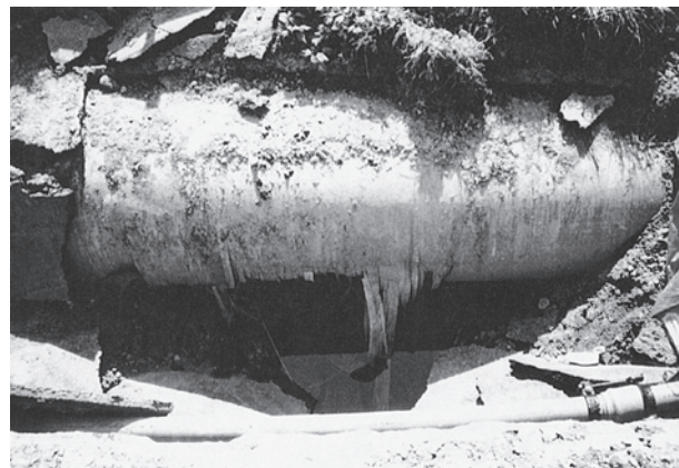
図3 破壊直後の状況
