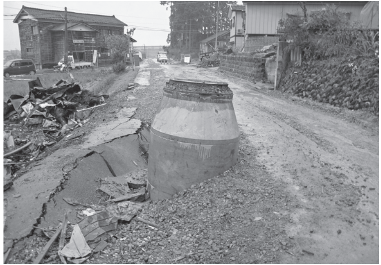
図9 液状化によって浮上したマンホール 地表面は20cm以上の沈下を生じ、管路は大きな不陸が発生している。
