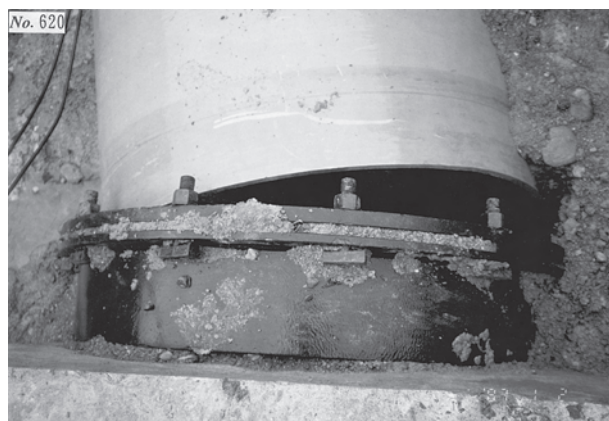
図7 スラストブロック部での変状(上)と管の抜けだし(下)
