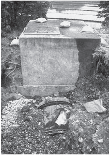
図8 マンホールの移動に伴う管の離脱 斜面の上部に位置する地形の変化点での状況
