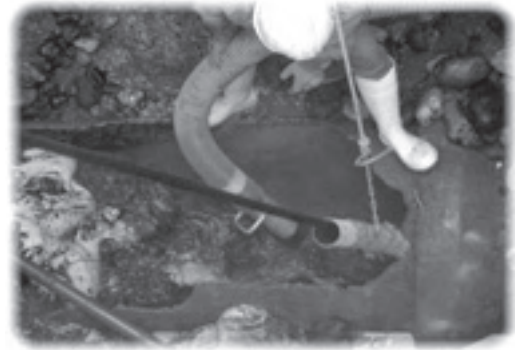
図-31 陥没時の管内の状況および復旧工事の様子（事例1）
