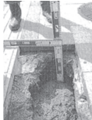
図-35 陥没事故（事例4）
