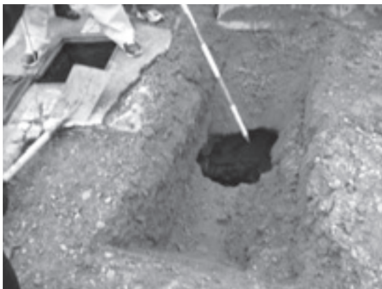
図-34 陥没事故（事例3）
