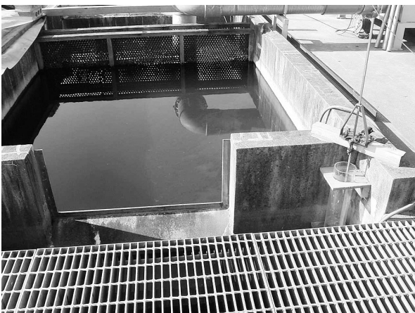
写真-5 量水槽、四角堰
