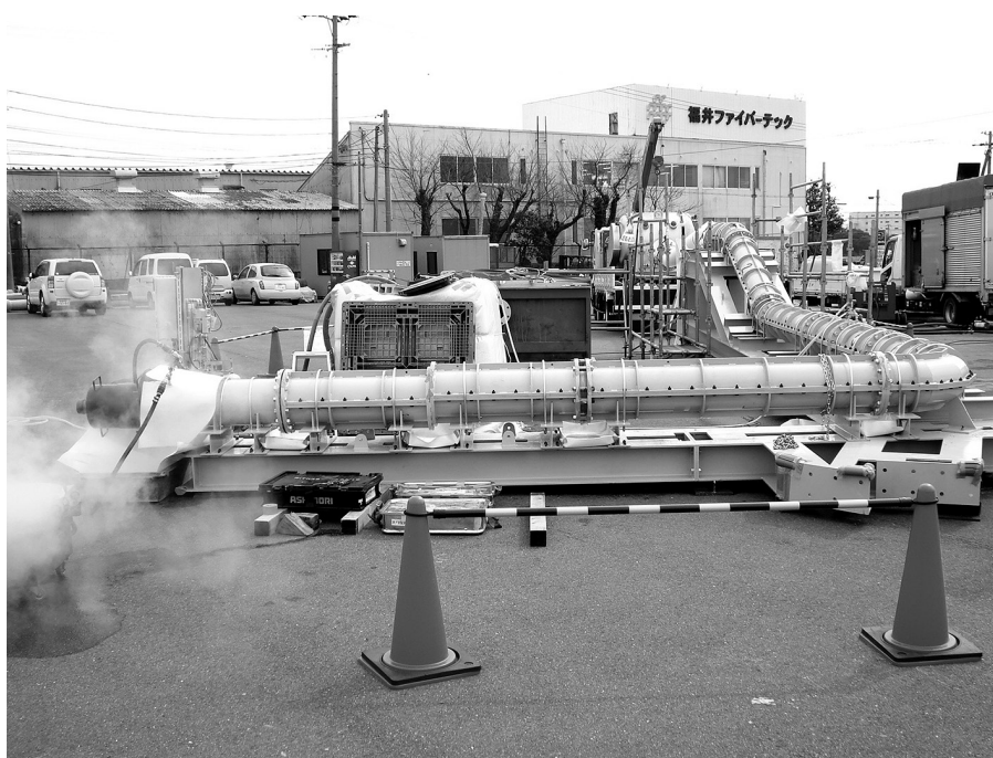
写真-1 配管状況
