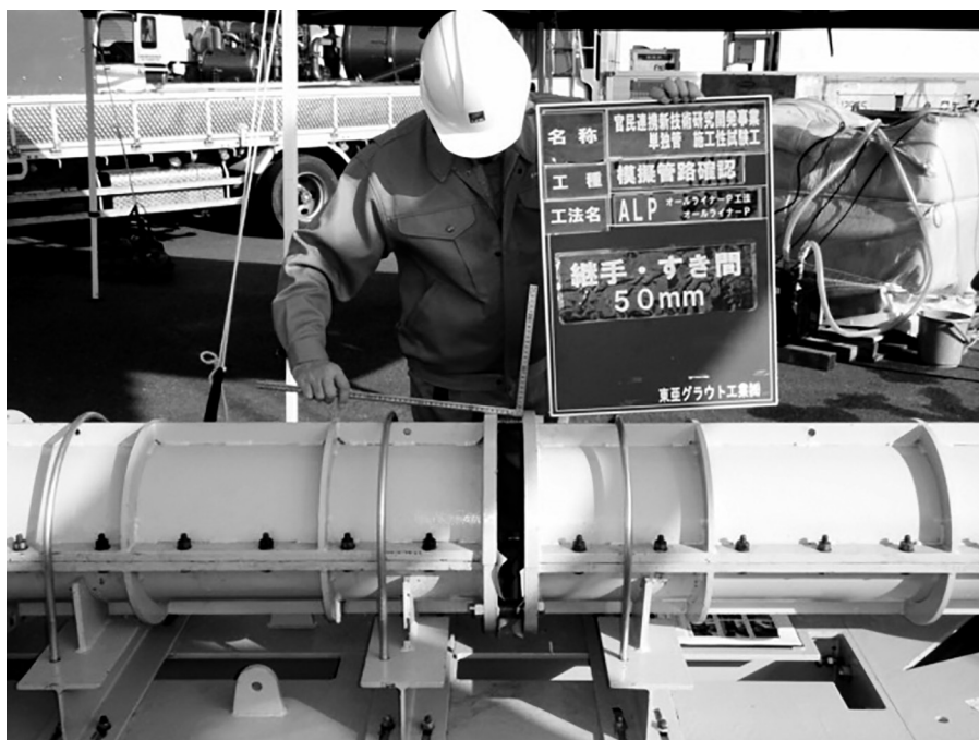
写真-6 継手部隙間
