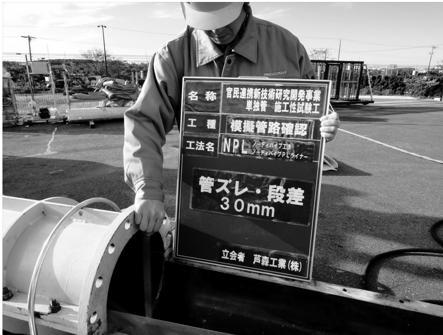
写真-7 管ズレ・段差
