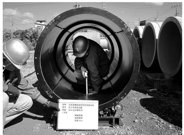
下段差測定状況 (3 cm)
